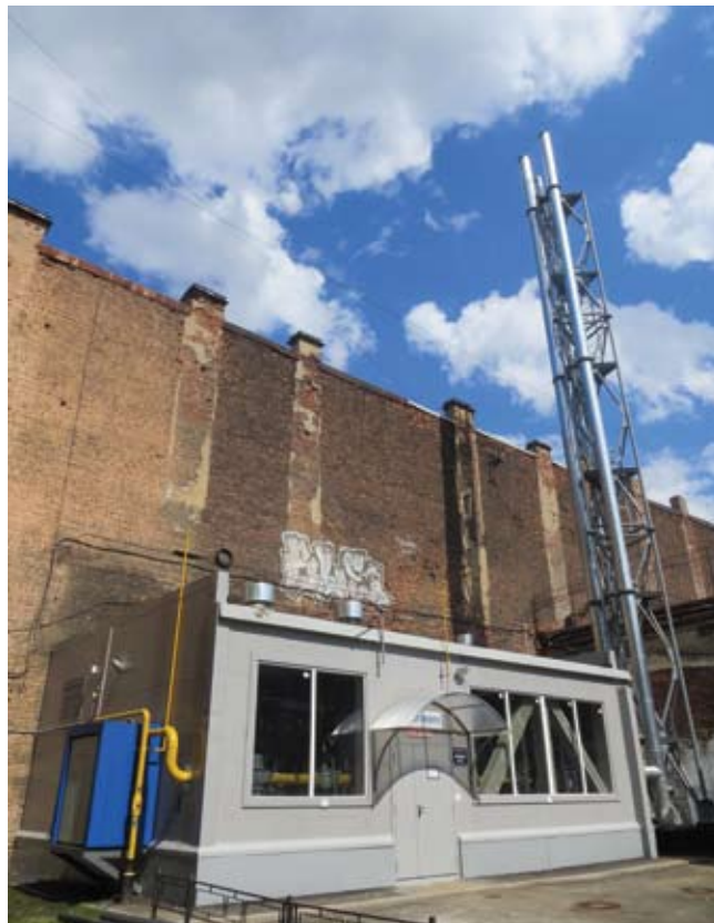
Котельная на Лиговском проспекте
